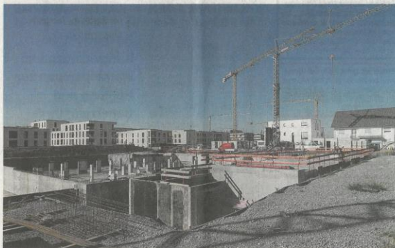
Grundstück gefunden, Kaufpreis und Baukosten sind fix – die Bauphase kann starten. Und die Nebenkosten?
